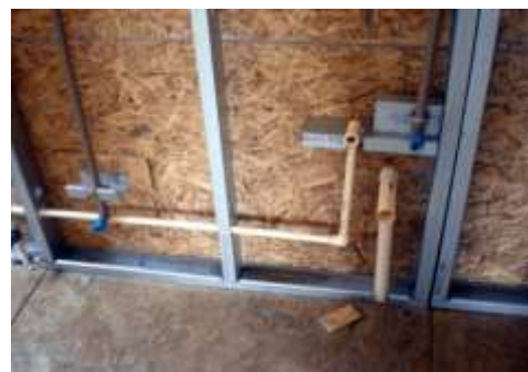
Hidraulica – Pex e Manifold
